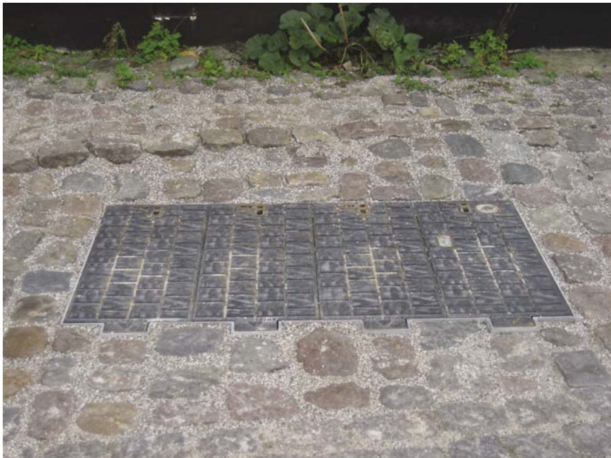
Kabelkassen i Strandgade med dens flotte finish .
